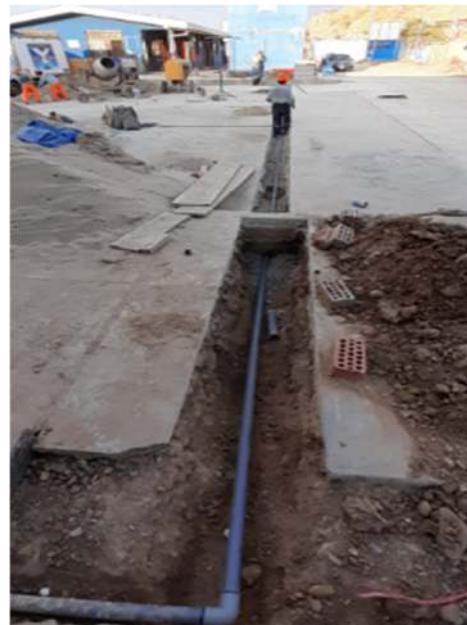
Tendido de tubería de 2" de agua que conecta a área de desinfección
