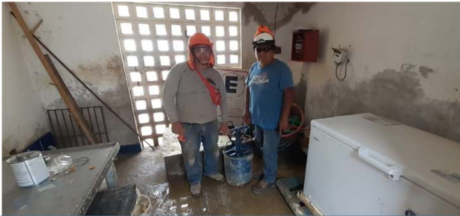
Prueba de balde de presión en tuberías de agua, inspección de la supervisión
