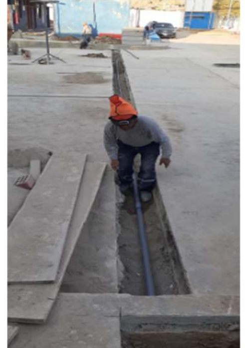
Colocación de tubería de 2" de agua que conecta a área de desinfección
